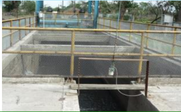
Cárcamo de Retorno a Canales de Riego
