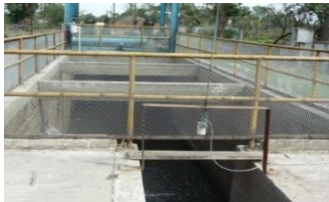
Cárcamo de bombeo a Riego Agrícola
