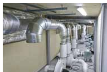
試験センターの室外排気設備 (一関ヒロセ電機)
