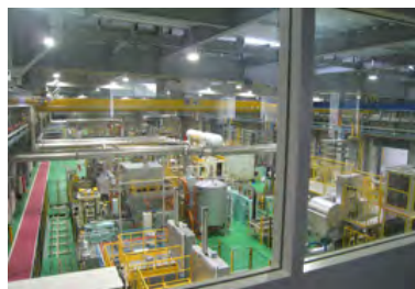
有人エリアから見た無人エリア（生産設備）
