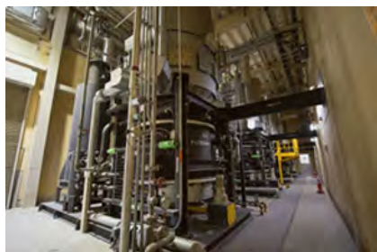
粟津工場バイオマスボイラー施設
