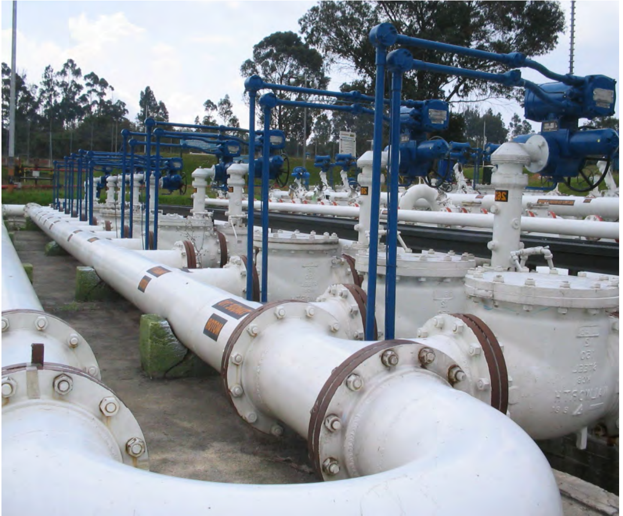
Ecopetrol. Estación de Transporte Mancilla . Departamento de Cundinamarca.
