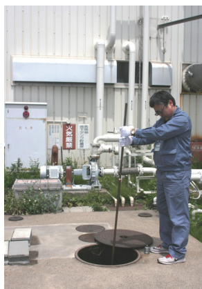
重油地価タンクの漏れ確認
