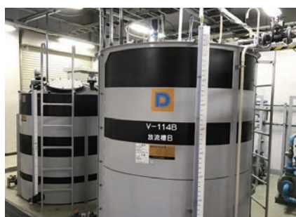
中和処理設備
