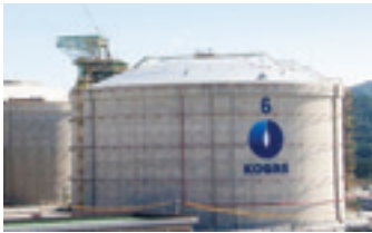
270,000kℓ LNG Storage Tank
