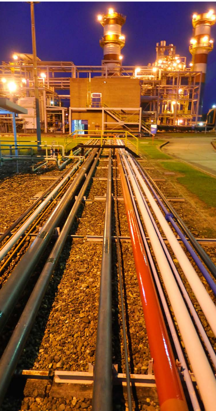
Central Térmica Termocentro (300 MW).
