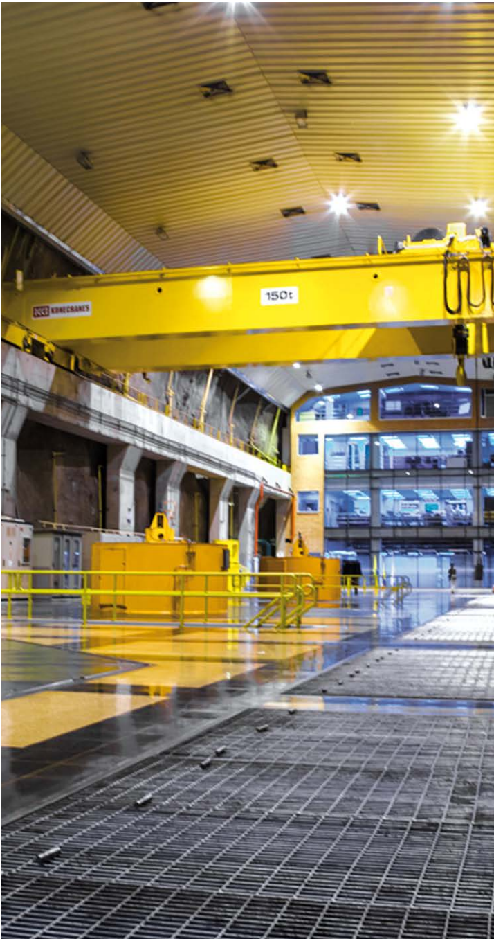
Casa de máquinas, Central Hidroeléctrica Miel I (396 MW).
