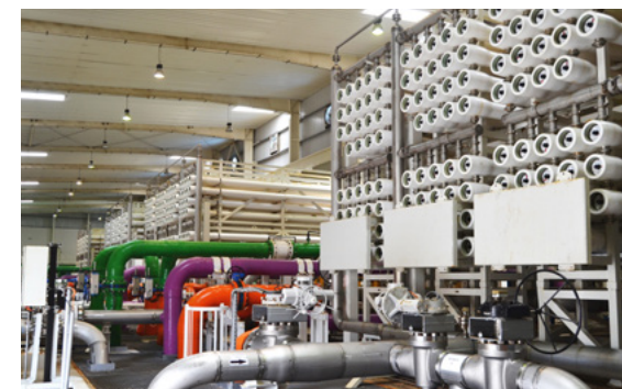
Ghana. Planta desaladora de Accra
