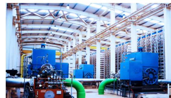
Argelia. Planta desaladora de Ténès
