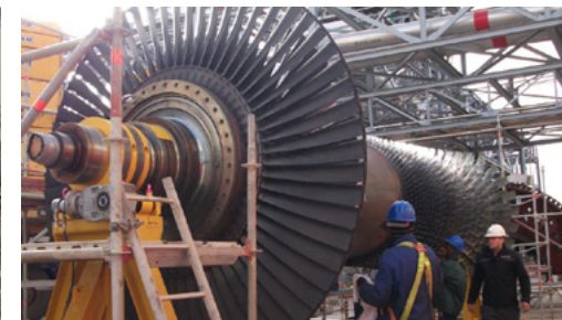
Abengoa opera la primera planta ISCC en entrar en operación comercial en el mundo y que genera el 10 % de la electricidad consumida en Marruecos
