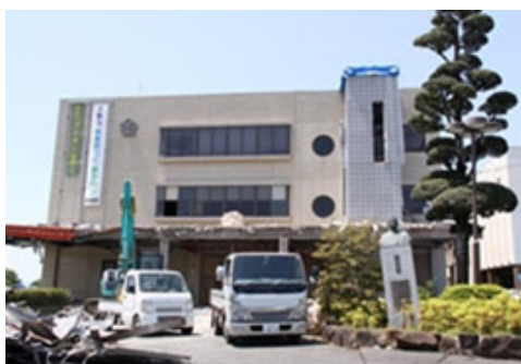
被災した益城町役場庁舎
