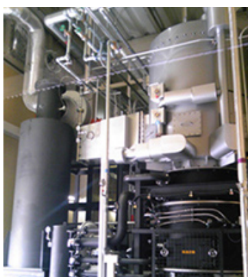
バイオマスボイラー（粟津工場）
