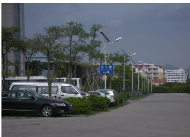
厂内太阳能路灯
