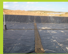
Celdas de seguridad
