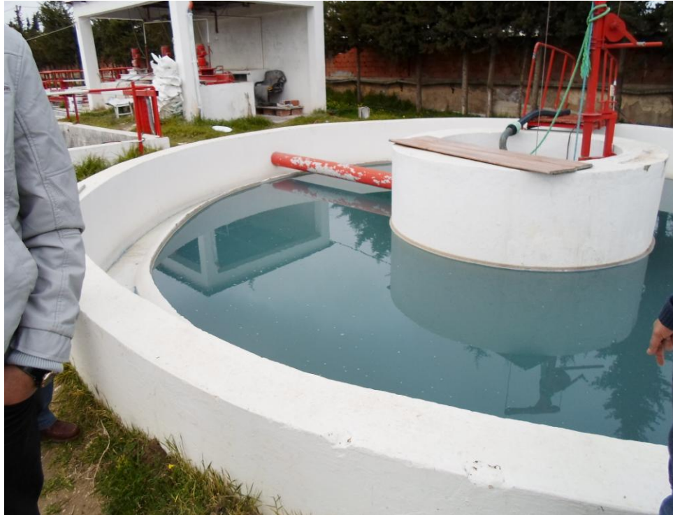
Station de traitement d'eau °2
