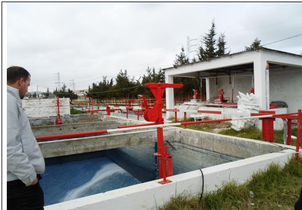
Station de traitement d'eau n°1
