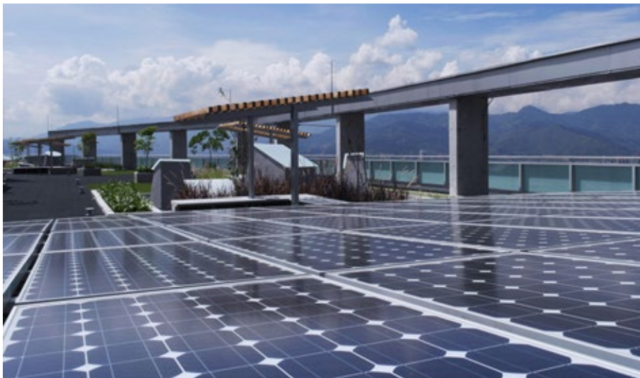
Celdas fotovoltaicas en la sede principal de ISAGEN en Medellín.
