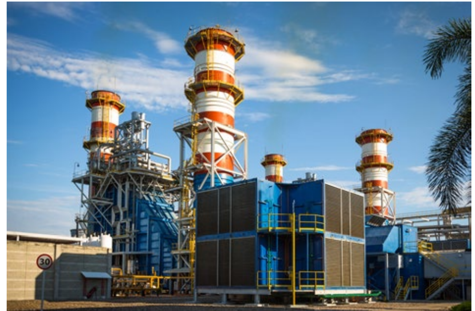
Central Térmica Termocentro.
