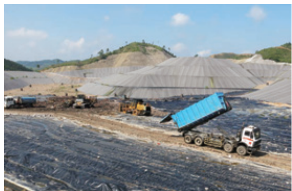
桂林市山口生活垃圾卫生填埋场作业现场 Landfill site of the city of Guilin at Shankou
