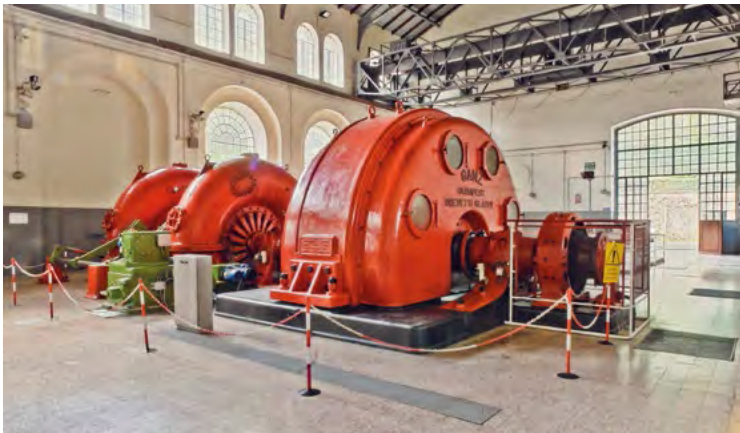
Castel Madama, provincia di Roma, una delle turbine all'interno della centrale idroelettrica
