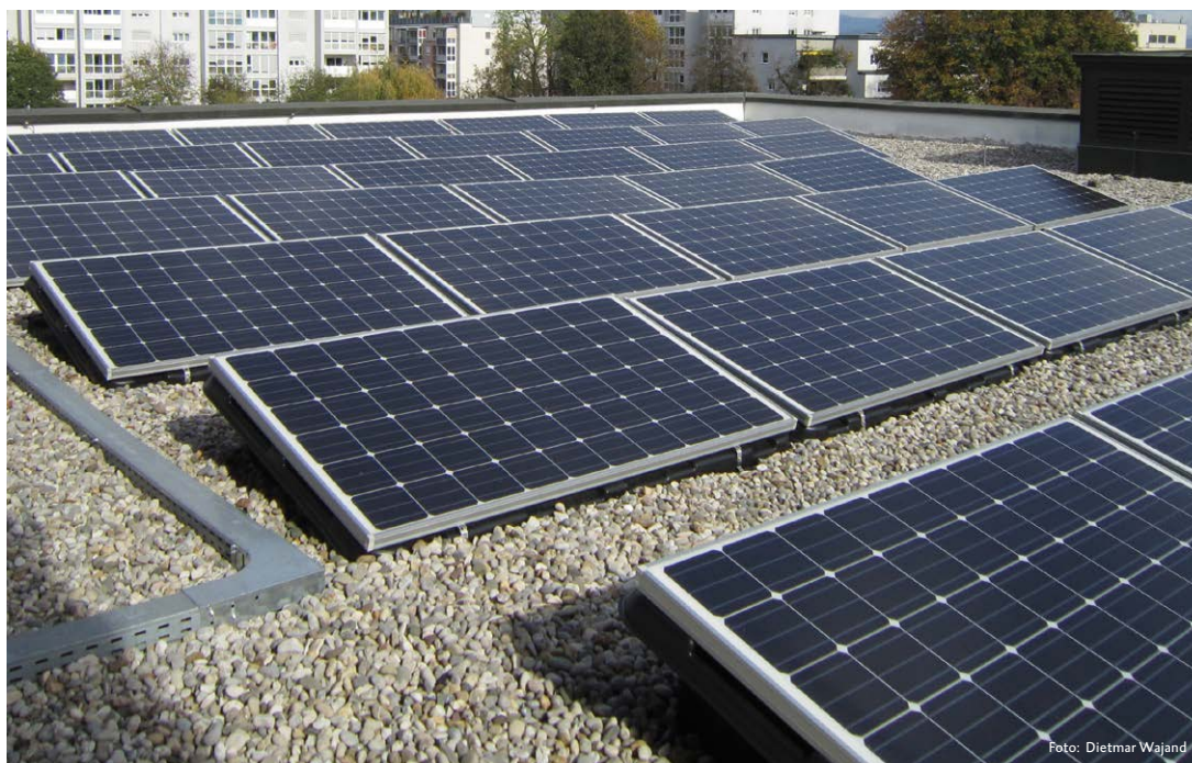
Unsere Photovoltaikanlage am Dach der Zentrale.
