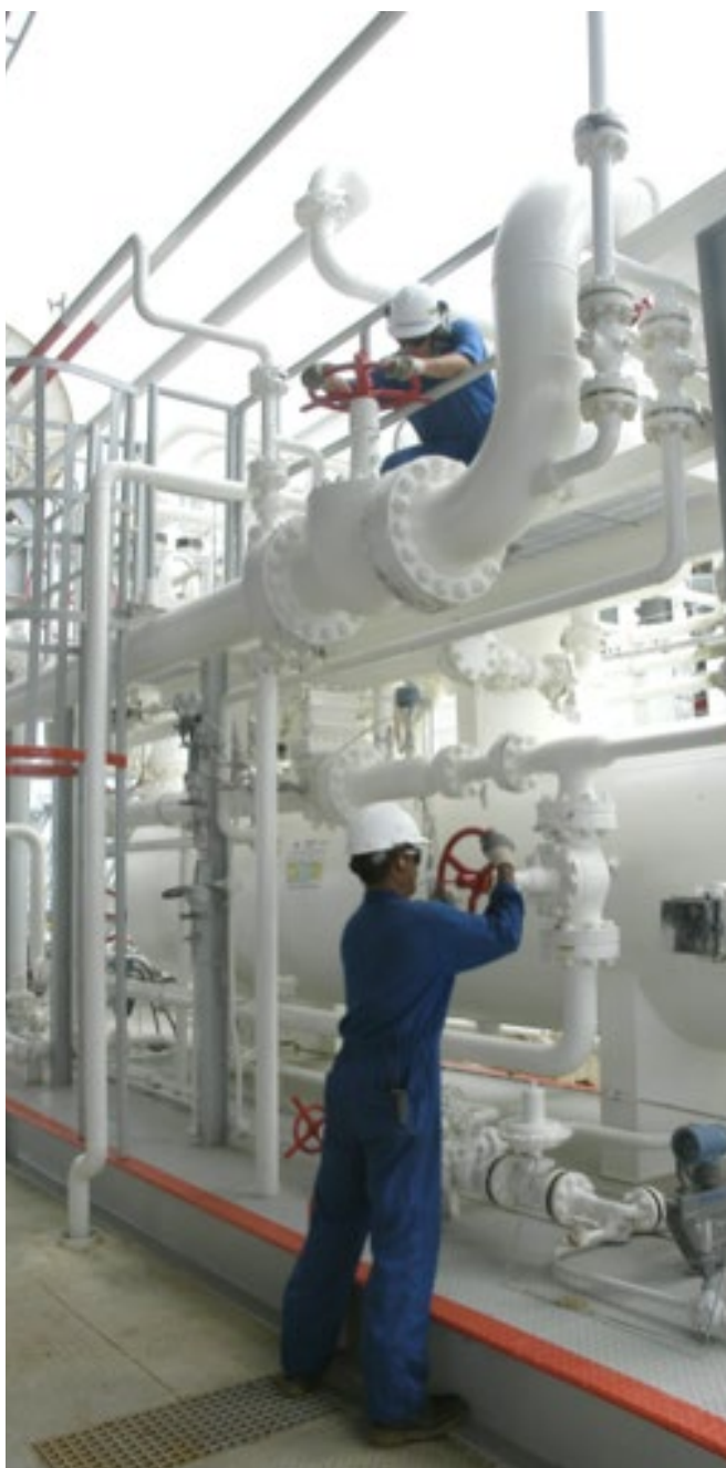
Trabajadores en la Plataforma de Chuchupa, en La Guajira.
