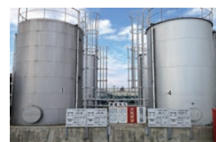
廃油分離層処理タンク
