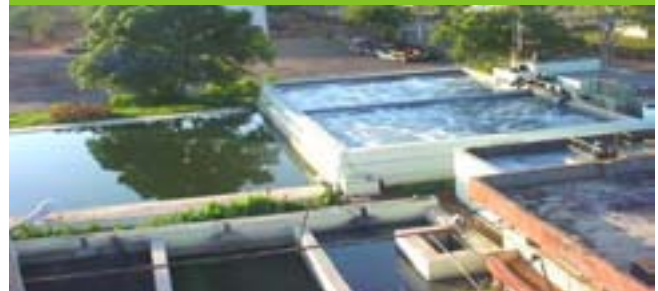
Effluent Treatment Plant (ETP)
