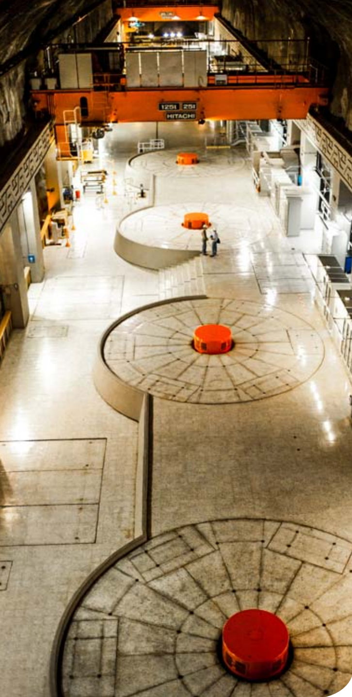
Central Hidroeléctrica San Carlos
