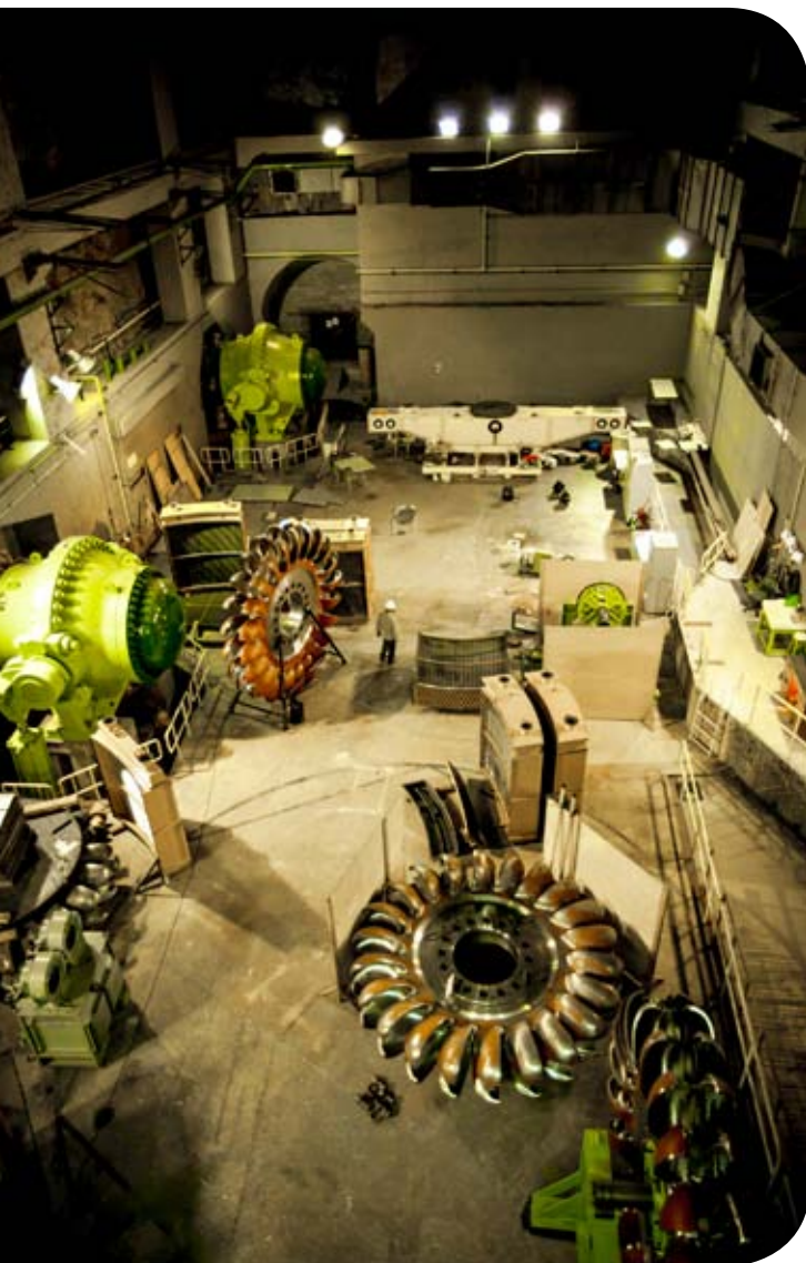
Central Hidroeléctrica San Carlos
