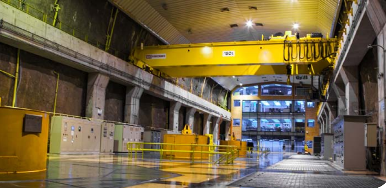
Central Hidroeléctrica Jaguas
