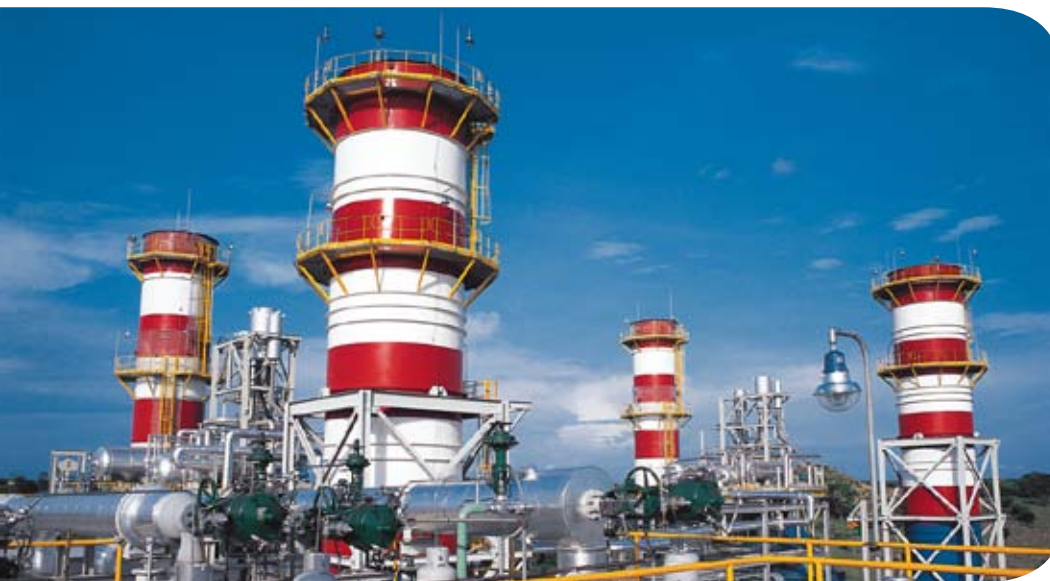
Central Térmica Termocentro
