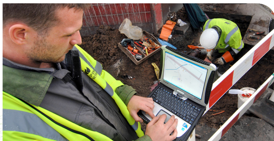
Técnicos comprueban líneas en Escocia (Reino Unido).
