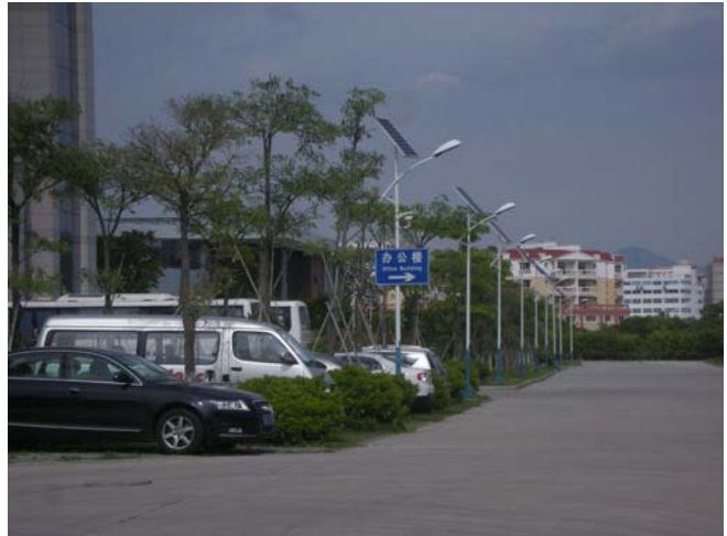
厂内太阳能路灯
