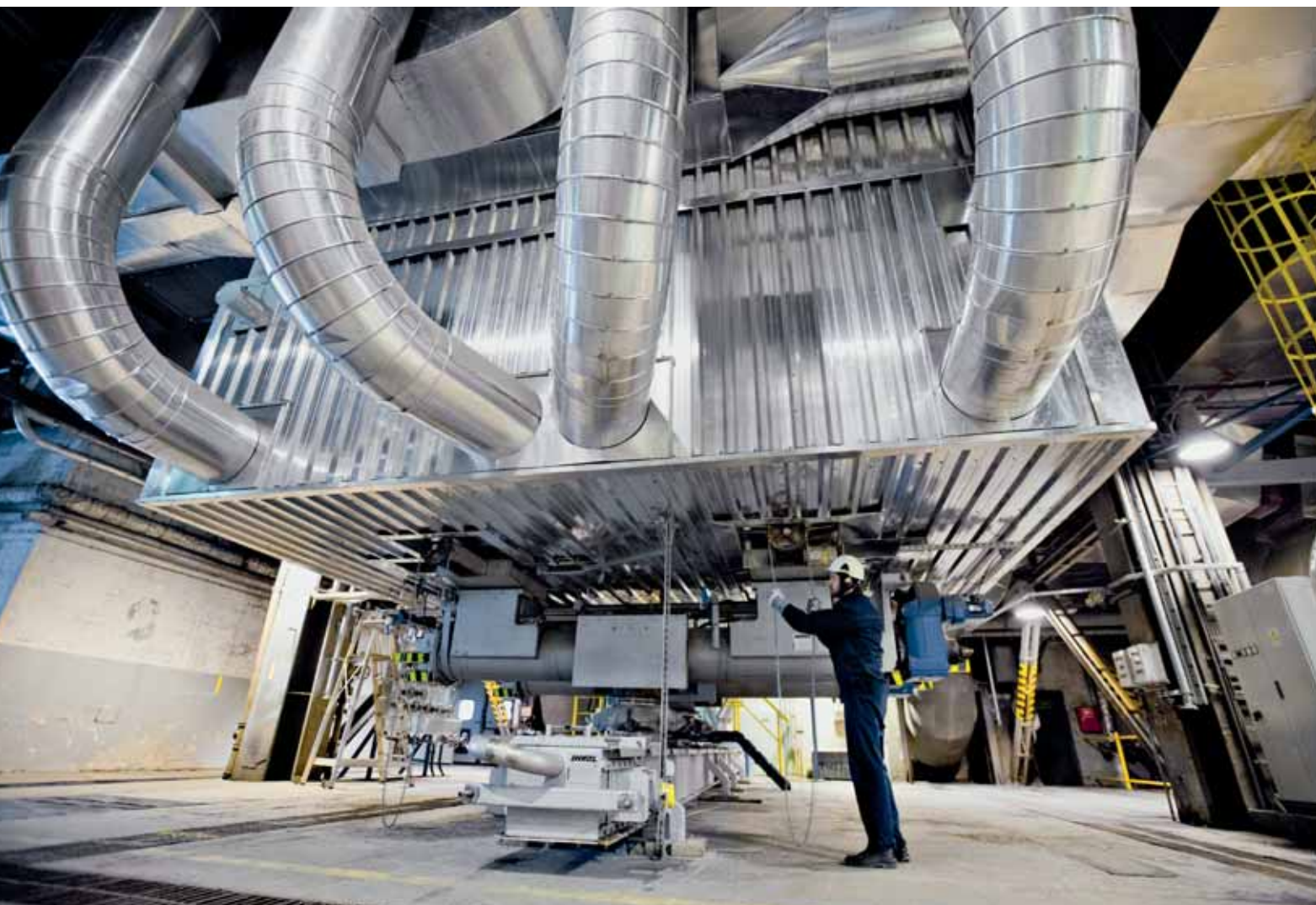
À Poznań (Pologne), une chaudière 100% biomasse équipe désormais le réseau de chaleur municipal.
