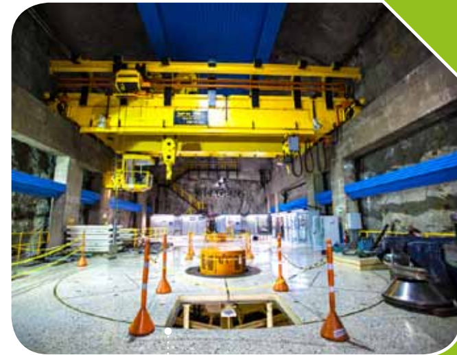
Central Hidroeléctrica Jaguas
