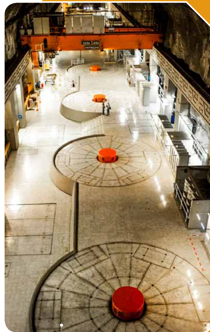
Casa de Máquinas. Central Hidroeléctrica San Carlos
