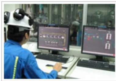
フィールド制御を行う制御室
