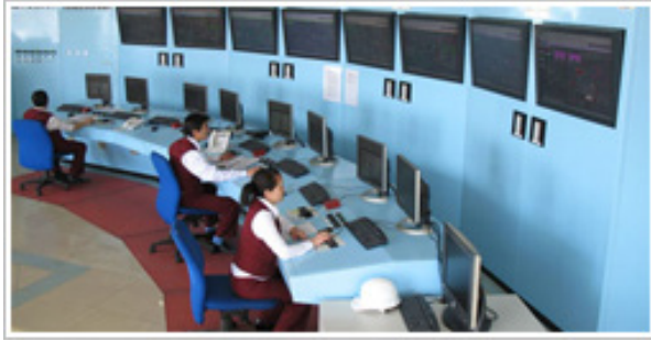
ボイラ制御室
