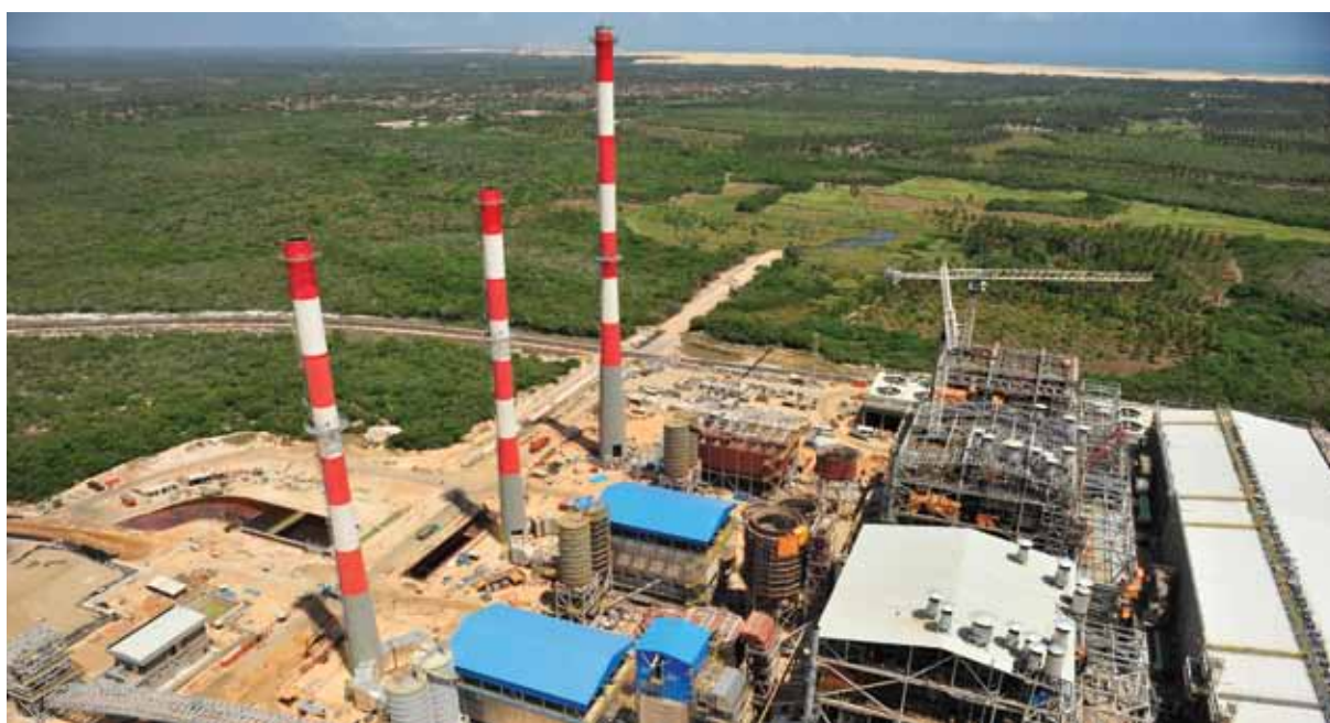
Pecém Thermal Energy - CE
