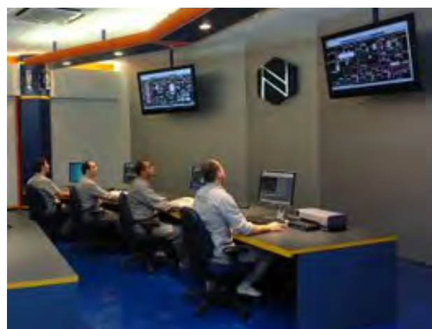
当社の制御システムが導入された、ブラジルの特殊ポリマー製造工場の中央制御室(NITRIFLEX社)
