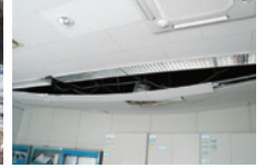
白河事业场的天花板掉落
